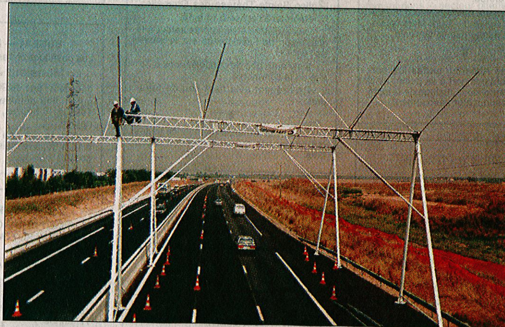
Une des images de marque de l'entreprise : le portique universel modulable conçu pour améliorer la sécurité du personnel et conserver la circulation des véhicules lors des travaux de déroulage des lignes aériennes.
